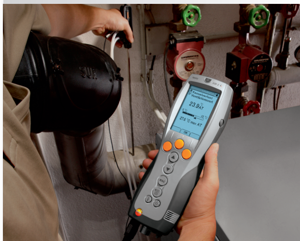
Messung der Strömungsgeschwindigkeit in der Abgasleitung
